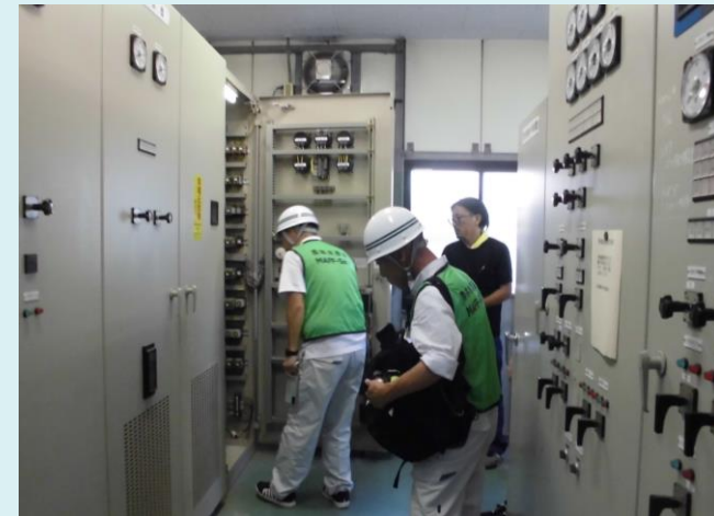
損傷した受電盤等の確認状況
